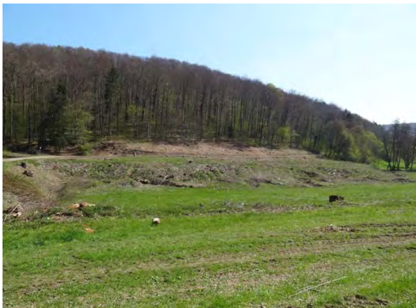
Baufeld unterhalb des bisherigen Damms (links), Wald- und Biotopfläche sind gerodet. (Quelle: Wald + Corbe)
