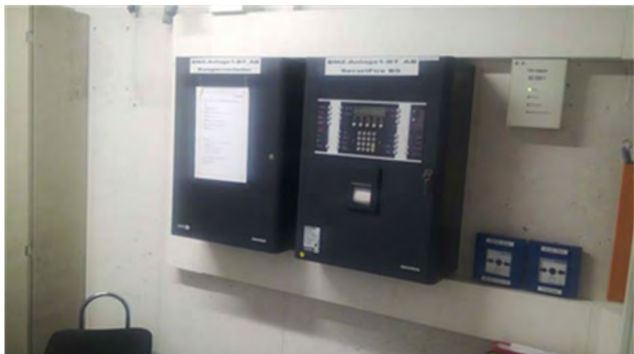
Brandmeldeanlage im Bauteil B 1. UG
